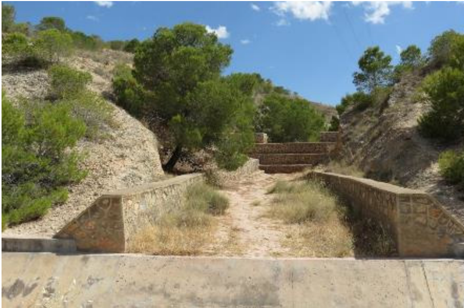
Foto 6. Encauzamiento del tramo final de uno de los barrancos en su entronque con el canal de avenamiento.
