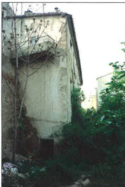
Figura 24. Estado actual del edificio donde se ubica el antiguo lavadero de Fiol (Alcoy). En la parte superior estuvo instalado el taller cerillero de Colomina y Moltó
