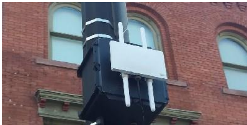
Ilustración 21: Dispositivo Meraki MR84 instalado en vía pública Fuente: https://www.one2call.net/broadband/wifi-survey-and-installation/ . Accedido el 29/04/2018
