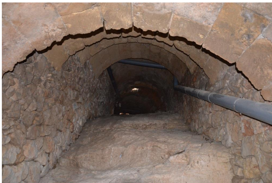
Fot. 39. Vista hacia aguas arriba. Autora: Núria Ginestar (17/03/2018).
