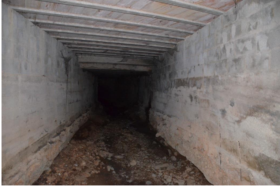
Fot. 25. Inicio del Tramo 3 (Sector III), vista hacia aguas abajo. Autora: Núria Ginestar (17/03/2018).
