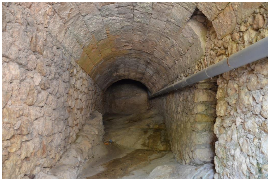
Fot. 41. Vista hacia aguas arriba. Autora: Núria Ginestar (17/03/2018).
