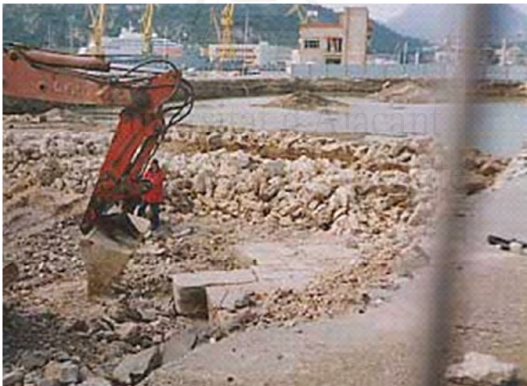
Fig. 15.5-2 Imagen durante la excavación para la construcción del aparcamiento del muelle Alfonso XII (La ciudad borrada. Crónica de la destrucción del conjunto histórico de Cartagena 1980-2006. Fotografía de Moisés Ruiz Cantero)
