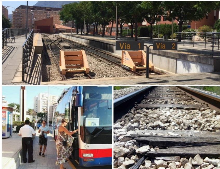
Figura 6. Situación actual de la Línea 9. Superior: estación de Denia completamente vacía. Inferior izquierda: servicio de autobús FGV. Inferior derecha: detalle del estado de las vías.
