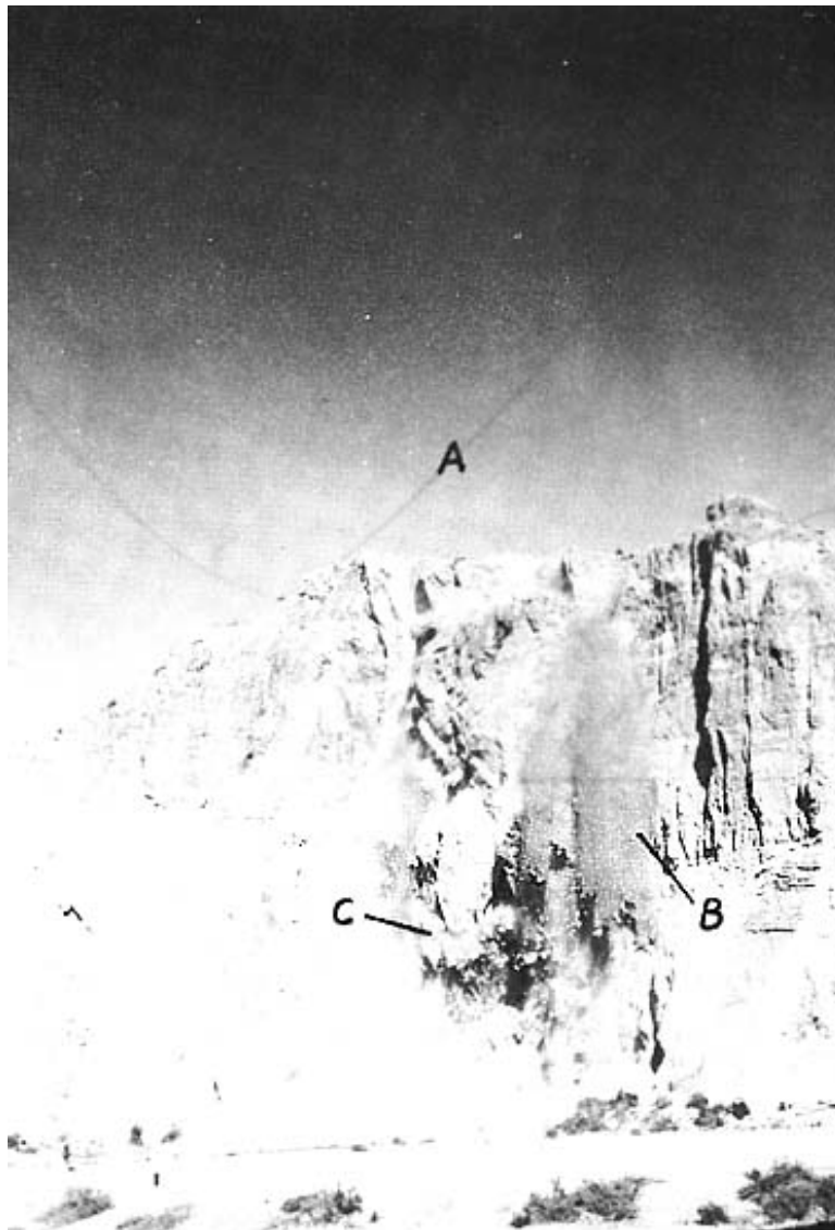
Figura 1.- Instantánea del desprendimiento. Obsérvese como la rotura se produce en el pie (señalado con C)
