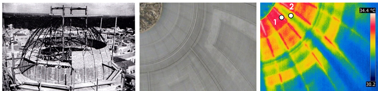
Figura 8. Imágenes de la Iglesia de Santa María de Elche. Imagen izquierda. Estructura metálica base para soportar la cúpula de ladrillo. Imagen central. Vista interior de la cúpula. Imagen derecha. Termografía de la cúpula con identificación de temperaturas destacadas T^a_1 (34,0 °C) y T^a_2 (32,0 °C). (Fuente imagen izquierda: García Navarro et al. (13), p. 82. Fuente imagen central y derecha: propia).
