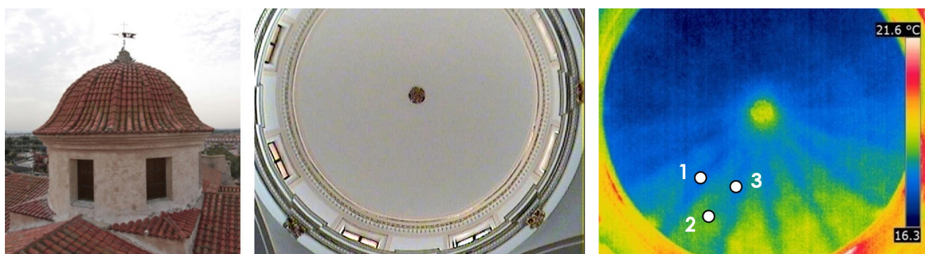
Figura 2. Cúpula de crucero en la Iglesia de San Felipe Neri en Crevillente. Imagen izquierda. Vista exterior de la cúpula. Imagen central. Vista interior de la cúpula. Imagen derecha. Termografía de la cúpula de crucero con identificación de temperaturas destacadas T^a 1 (17,7 °C), T^a 2 (18,4 °C) y T^a 3 (17,7 °C). (Fuente propia).
