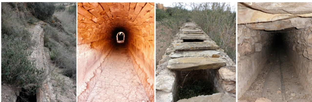
Figura 4. Acequia de bóveda de cañón y acequia rectangular cubierta de la canalización de Casa Grande.
