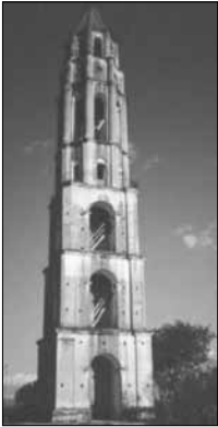
Torre de Manaca Iznaga. Valle de los Ingenios, Trinidad. Fotografía de José Gomariz.
