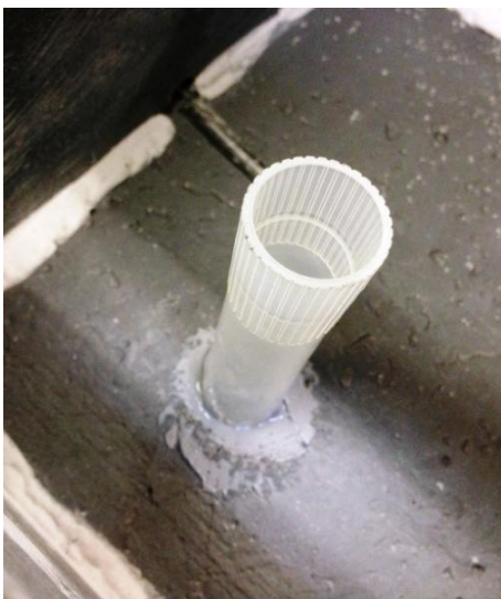
Detalle de tubo para albergar electrodo de referencia
