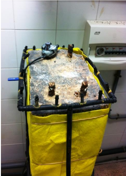
Detalle de conexión catódica
