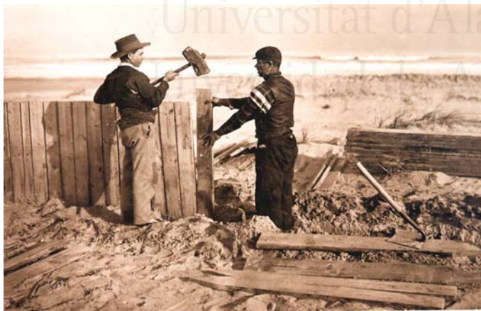
Colocacion del tablestacado para formar la duna litoral o contraduna y detener en la playa la arena que continuamente avanza el mar en ella. Año 1901.
