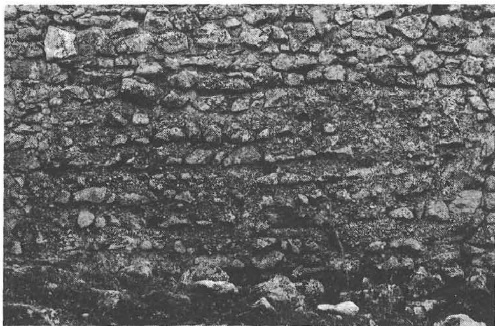
Fig. 6. —Façana de la casa 3. És perceptible l'existència de dos tipus constructius: un més primitiu, en la base del mur, de tapiades amb abundància de morter de calç i grava i una part reduïda de còdols. Sobre aquesta descansa un mur posterior de maçoneria ordinària presa amb morter de calç, sense cap ordre en la col·locació dels còdols.
