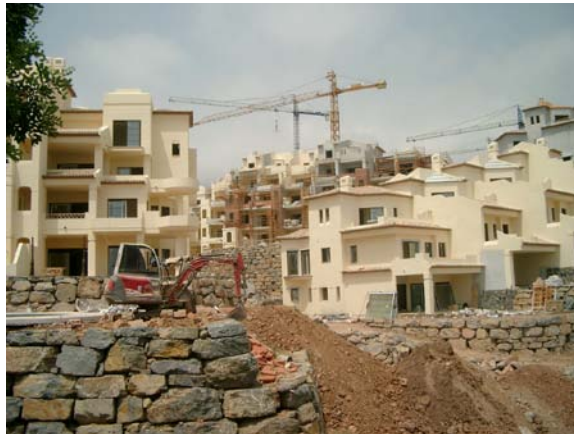
Imagen 3. Urbanización en plena fase de ejecución en la Finca Villa Gadea en Altea (Mazón).
