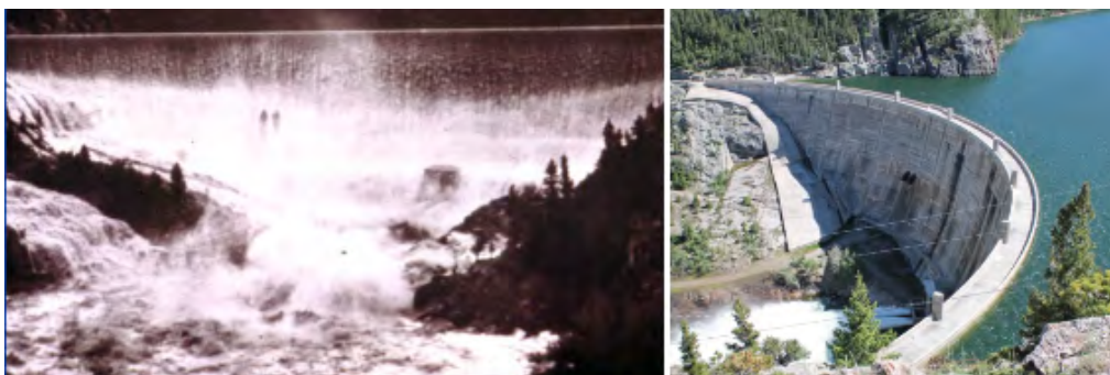
Figura 2. Presa de Gibson (USA). (a) Sobrevertido, 1964. (b) Refuerzo estribo derecho, 1981 (FEMA, 2014).
