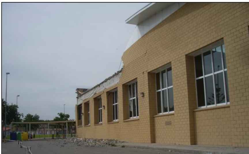
Fig. 5.7 Caída de antepecho de bloque sin armar en un edificio dotacional de Lorca.
