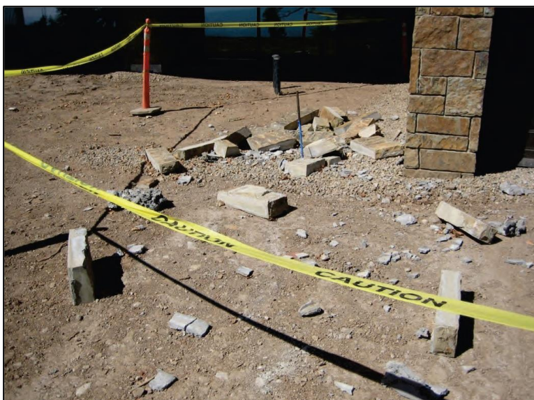
Fig. 4.8. Fragmentos de revestimiento de fachada, magnitud 4.4
