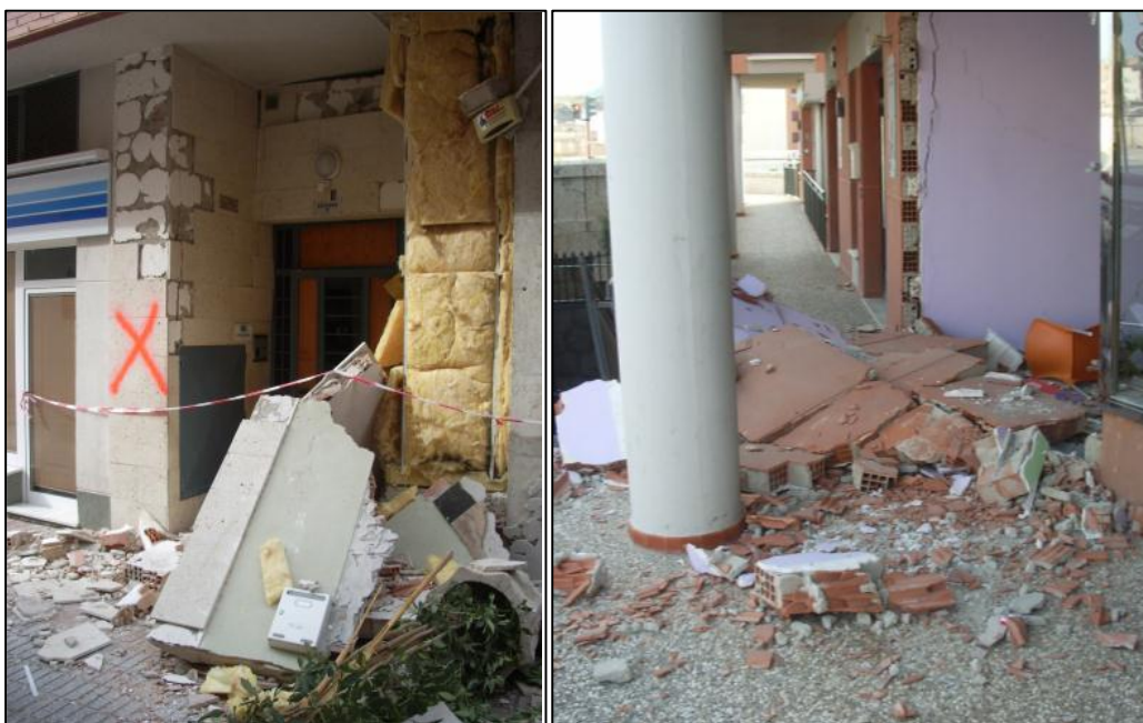
Fig. 5.8 Fallo de cerramientos no estructurales bloqueando las salidas de edificios o locales.
