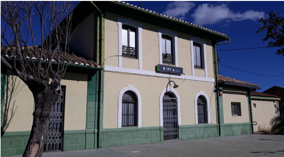
Figura 3. Estación de Sax, donde se aprecia la cubierta de teja de los cuerpos laterales. Fotografía: autor, noviembre de 2019.
