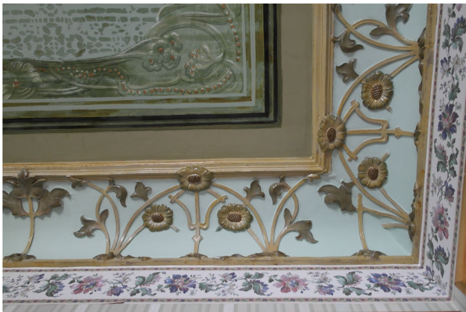
Figura 4. Detalle moldura de escayola modernista de la antecámara del dormitorio principal de la casa. Fotografía: José Vicente Carpio.
