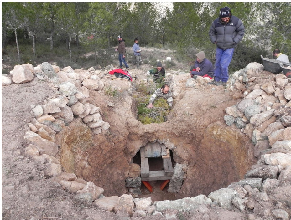
Figura 6. Proceso de recuperación del tiro y boca del horno, por medio de una pseudocimbrado realizada con tablas, listones de madera y ramas de arbolado. Fotografía: ARPA Patrimonio.
