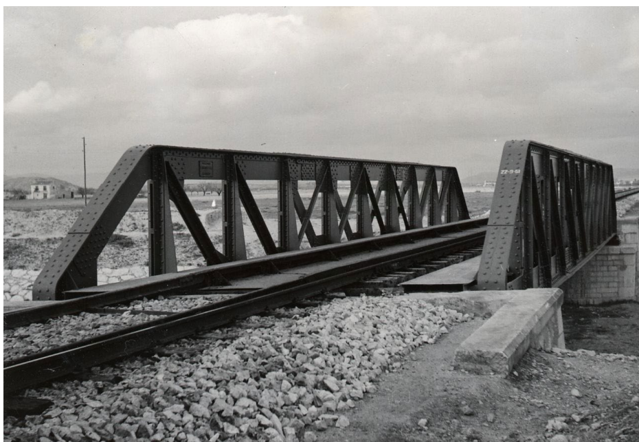
Figura 2. Vista desde el estribo del lado de Alicante del puente sobre el río Vinalopó, situado en el km 400, 237 de la línea de Madrid a Alicante. Fecha: 14/12/1951. Signatura: FA-0023-069. Fuente: Archivo Histórico Ferroviario del Museo del Ferrocarril de Madrid-Fundación de los Ferrocarriles Españoles (Colección del AHF/Álbumes fotográficos. Partes semestrales de obras RENFE).
