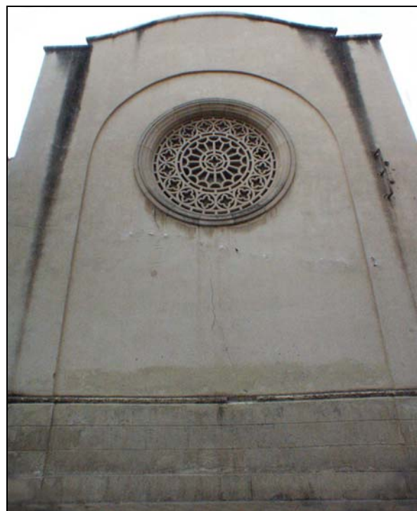
Figura 8. Fachada posterior (Norte) con lesiones por humedad.
