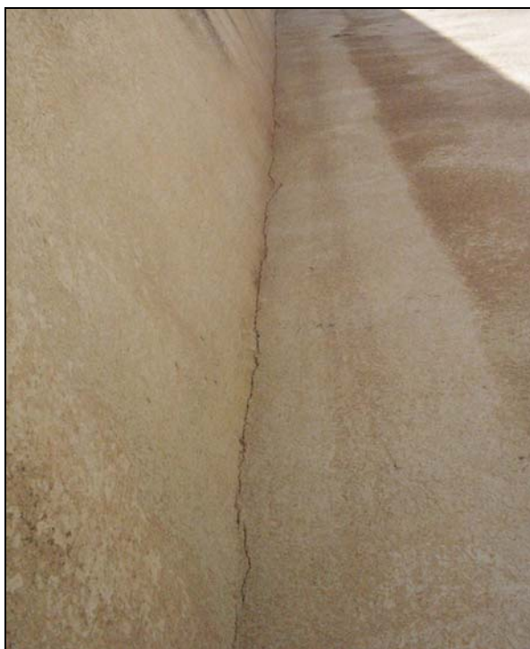
Figura 7. Fisura vertical por la diferencia de materiales.
