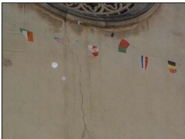
Figura 5. Fisura vertical pasantes en los rosetones.
