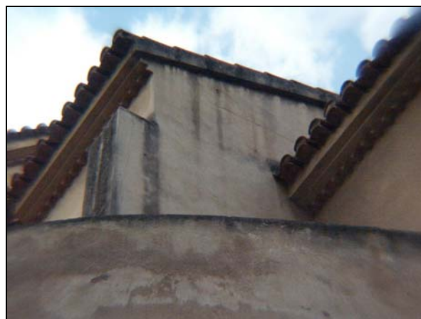
Figura 6. Fisura horizontal por empujes en la cubierta plana.
