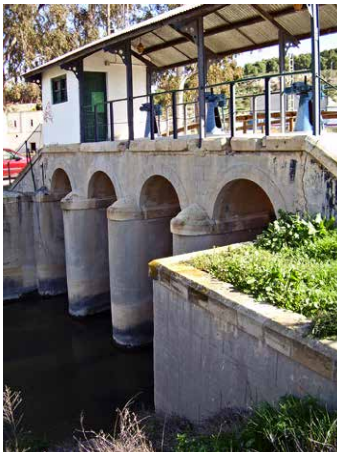
Figura 7: Les comportes de captació d'aigua del Segura de Regs de Llevant a la zona de l'assut de sant Antoni, en la Zona Humida nº 24.
