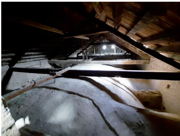
Fig. 3. Trasdós de la bóveda central. Imagen general. Foto: Marina Albaladejo Cerezo.
