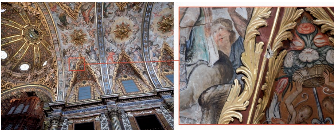
Fig. 2. Detalle de la zona de caída de fragmentos. Luneto del primer tramo de la bóveda. Foto: Marina Albaladejo Cerezo.
