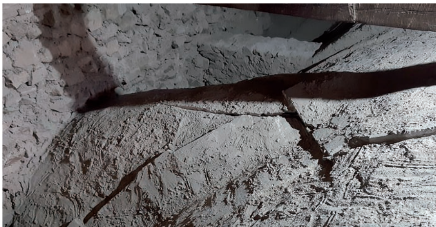
Fig. 7. Grieta transversal a un luneto en el trasdós de la bóveda. Foto: Marina Albaladejo Cerezo.
