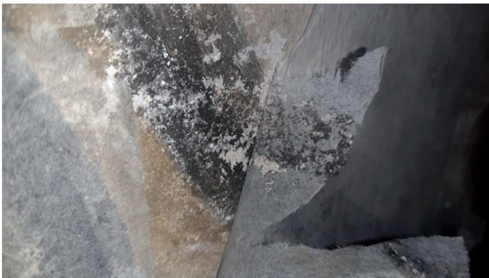
Fig. 16. Primer proceso de consolidación, con retirada parcial de la pintura, que posteriormente fue repetida hasta conseguir la total adhesión de la pintura al muro. Foto: Marina Albaladejo Cerezo.
