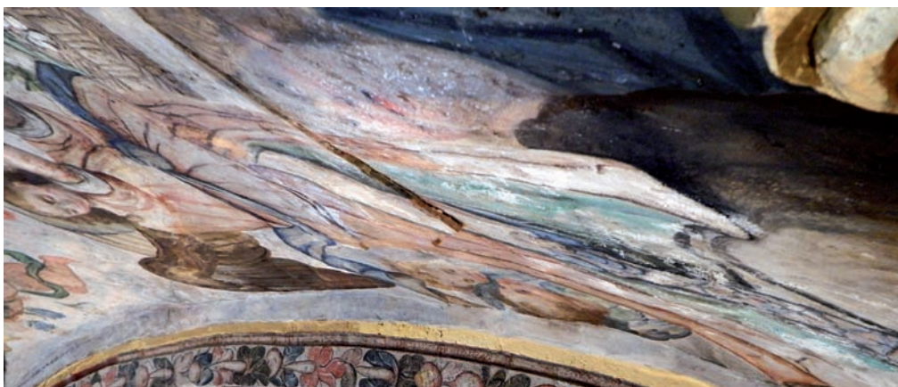
Fig. 8. Desplazamiento de los dos labios de una de las grietas por el intradós de la bóveda. Foto: Marina Albaladejo Cerezo.
