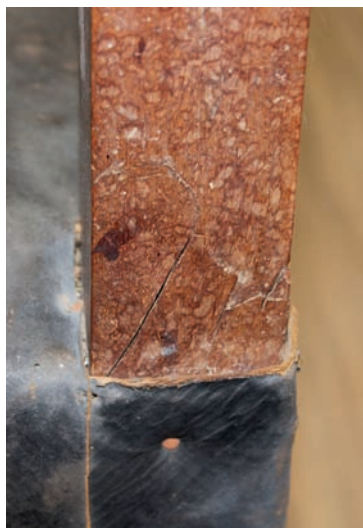
Fig. 15. Detalle de fisura en la estructura y manchas de agua. Foto: Elisa Martínez Zerón.
