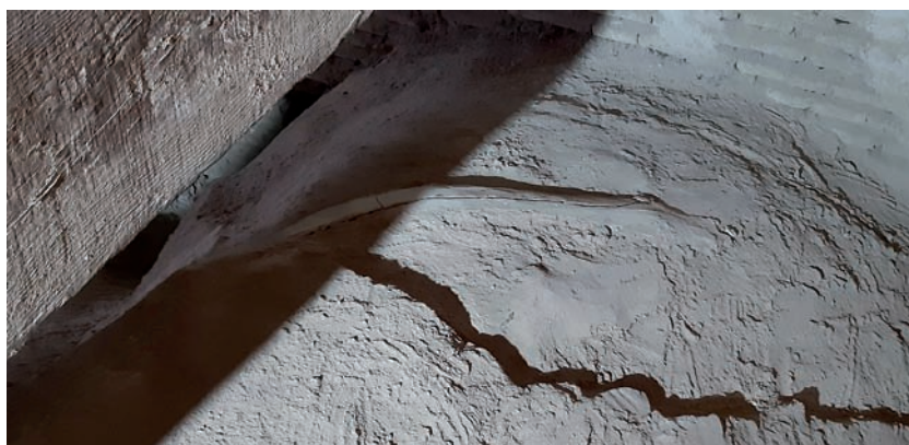
Fig. 10. Reparación de una de las grietas en otro luneto, engrosando con mortero, que desgraciadamente se ha vuelto a fracturar por el mismo lugar. Foto: Marina Albaladejo Cerezo.
