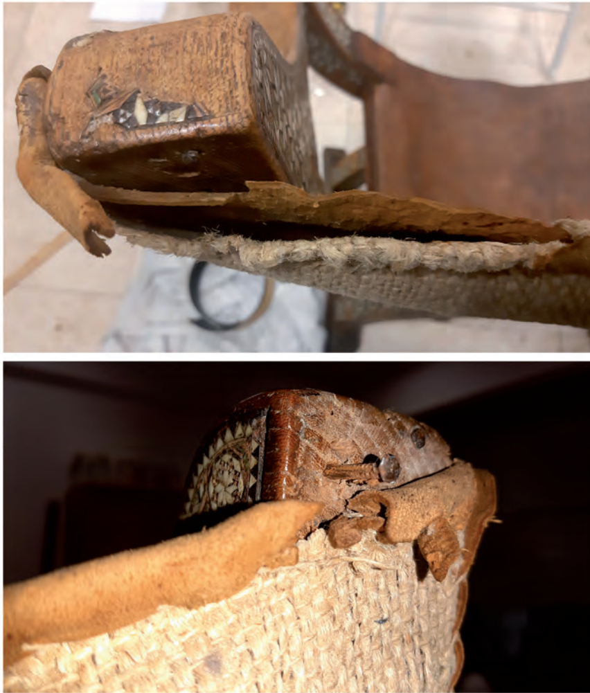
Fig. 20. Descosido y falta de soporte en el respaldo de las Jamuga 1 y Jamuga 2 respectivamente. Foto: Marina Albaladejo Cerezo
