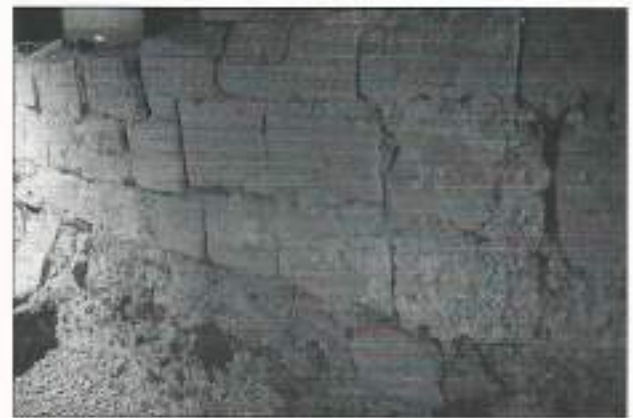
Fig. 15. Paramento interno del Tramo III, se aprecia la sillaría. (Foto A. Aragón).
