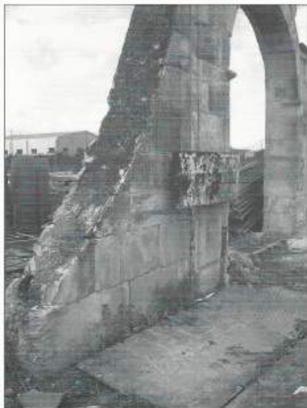
Fig. 1. Detalle. Estado inicial conservación
