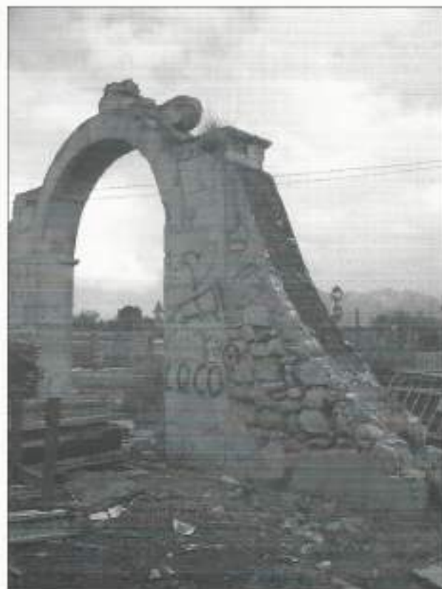
Fig. 2. Detalle. Estado inicial conservación
