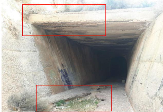
Figura 44. Evidentes condiciones de deterioro estructural de la solera y la tapa de hormigón que conforman la entrada del colector y, a la derecha, acumulación de depósitos sedimentarios en el fondo del canal fruto de las recurrentes avenidas de agua. Elaboración propia.
