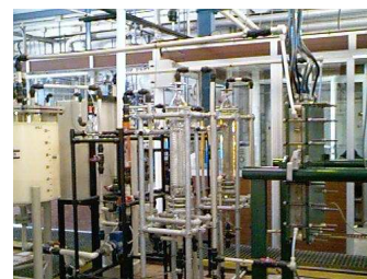
Instalaciones en la Planta Piloto
