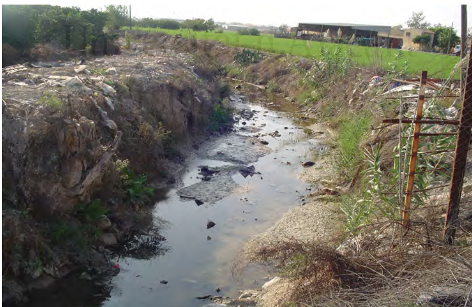
Fotografía 38. Azarbe de Abanilla a su paso por el término municipal de Dolores (Bajo Segura). Se observa la contaminación por residuos sólidos.
