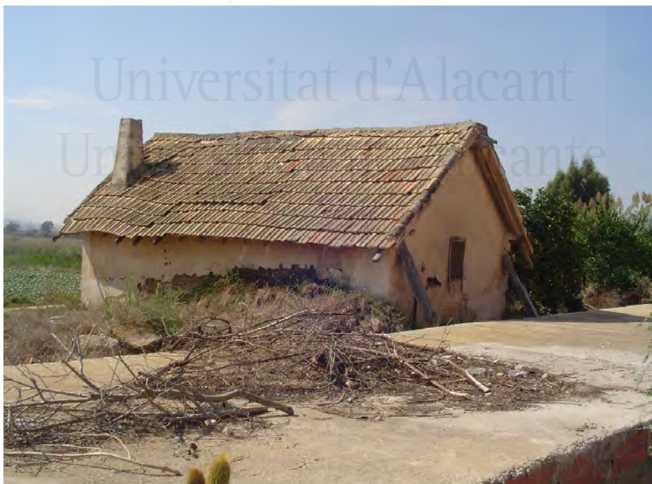
Fotografía 55. Casa abarracada en precario estado de conservación, junto al azarbe de Abanilla (Dolores, Bajo Segura).
