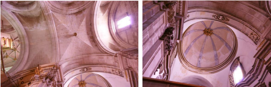
Figura 1: Vista cenital estado actual de la cúpula (izquierda) y del tramo abovedado (derecha).
