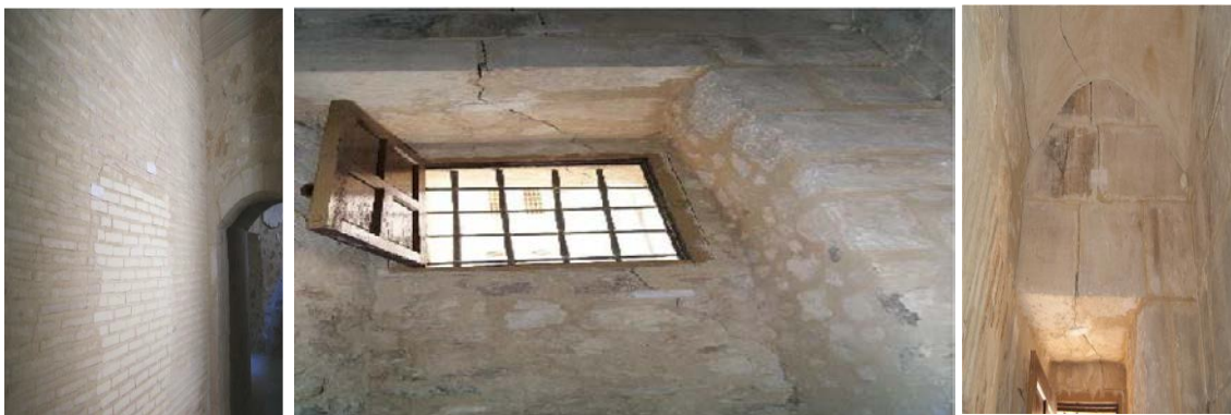
Figura 3: Grietas y fisuras en pasillo que conecta la Sacristía y la Capilla de la Comunión.
