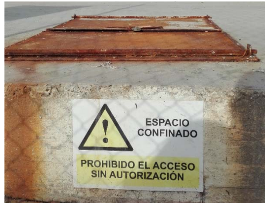
Figura 20. Señalización de espacio confinado. Fuente: Autor.
