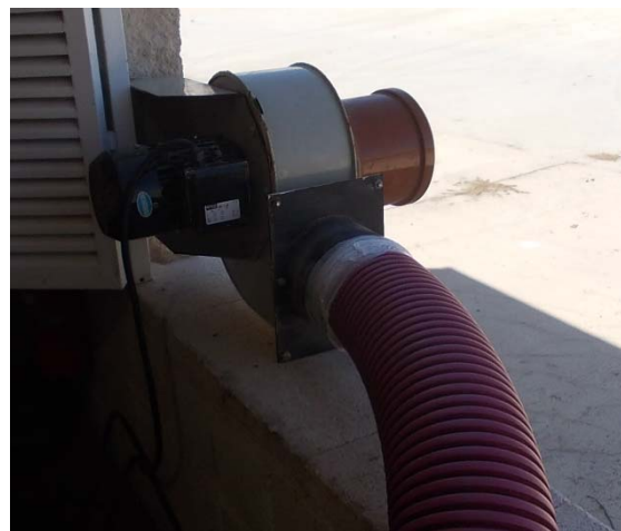
Figura 29. Toma de aire limpio. Fuente: Autor.
