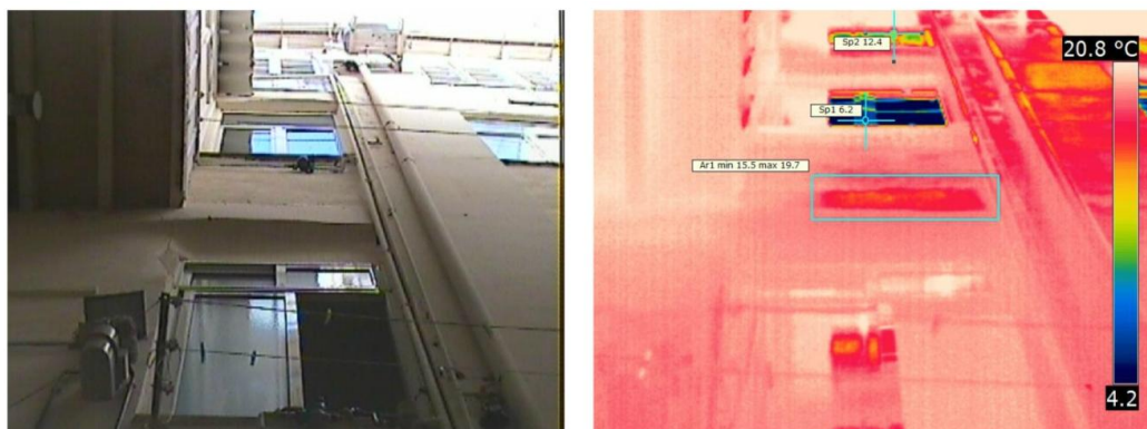
Figura 99: Termografía 5. Puente térmico viga madera
