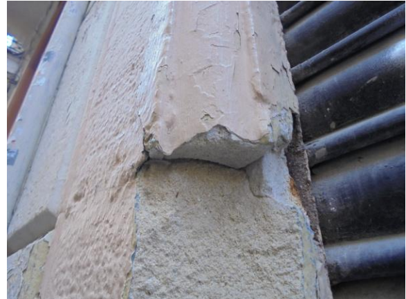
Figura 56: Roturas en fachada (Fuente: Autora)
