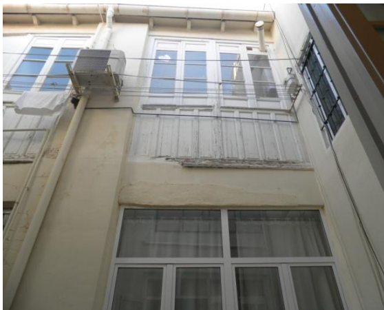
Figura 57: Estado cerramiento patio 1 (Fuente: Autora)
