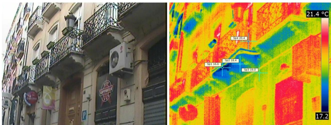
Figura 96: Termografía 2. Humedades en losa de balcón y homogeneidad en fachada
