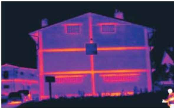
Figura 33: Puentes térmicos en fachada (Fuente: Guía de la termografía infrarroja (2.011, Pág. 132))
