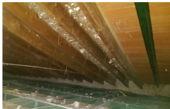
Figura 65: Estado actual de cubierta inclinada (Fuente: Autora)
