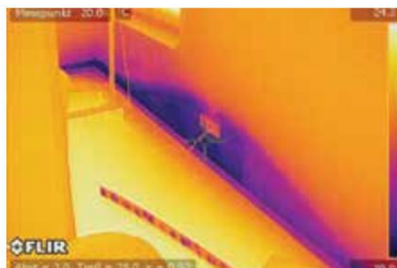
Figura 36: Humedades en base de cerramiento
