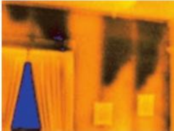
Figura 31: Deficiente colocación de aislamiento de espuma (Fuente: Introducción a los principios de la termografía (2.009, Pág.41))
