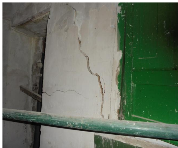
Figura 51: Grieta en muro de carga en planta baja (Fuente: Autora)
