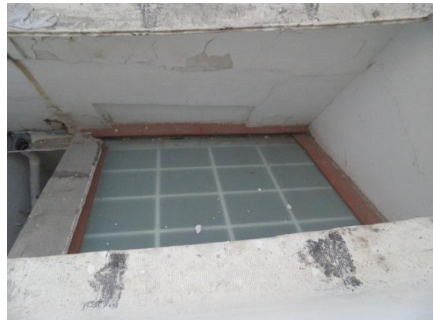
Figura 58: Estado cerramiento patio 3 (Fuente: Autora)
