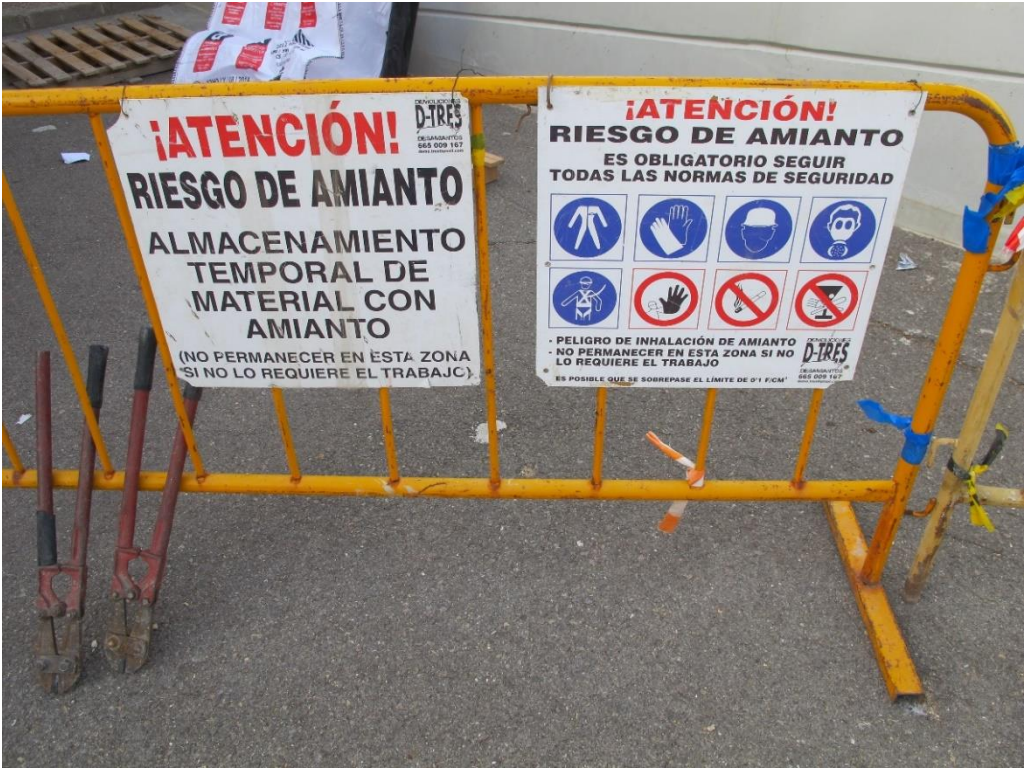
Figura 36. Señalización de obra, riesgo de amianto. Fuente: Elaboración propia.
