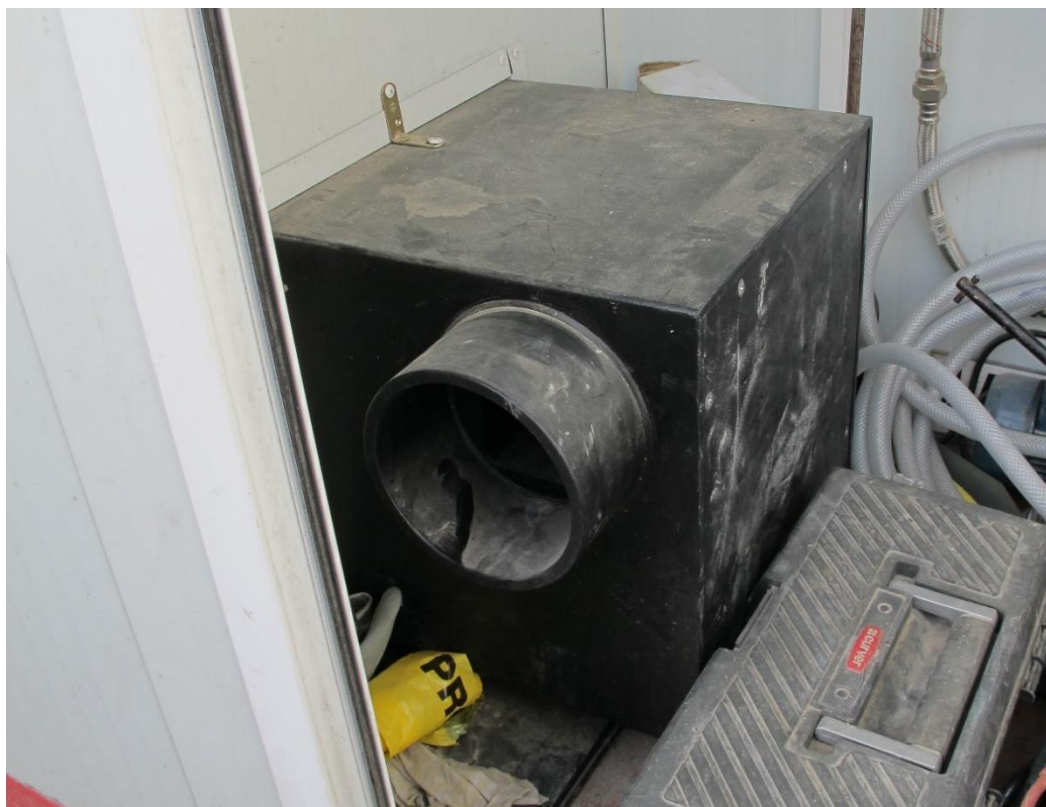
Figura 5. Aspirador con filtro de alta eficacia, interior cuarto técnico. Fuente: Elaboración propia.
