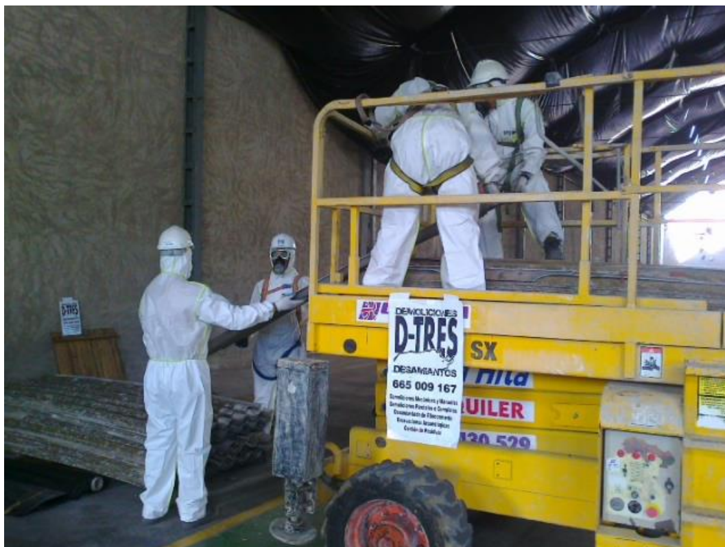
Figura 75. Desmontaje de cubierta de fibrocemento desde plataforma motorizada, descarga sobre zona de acopio.
