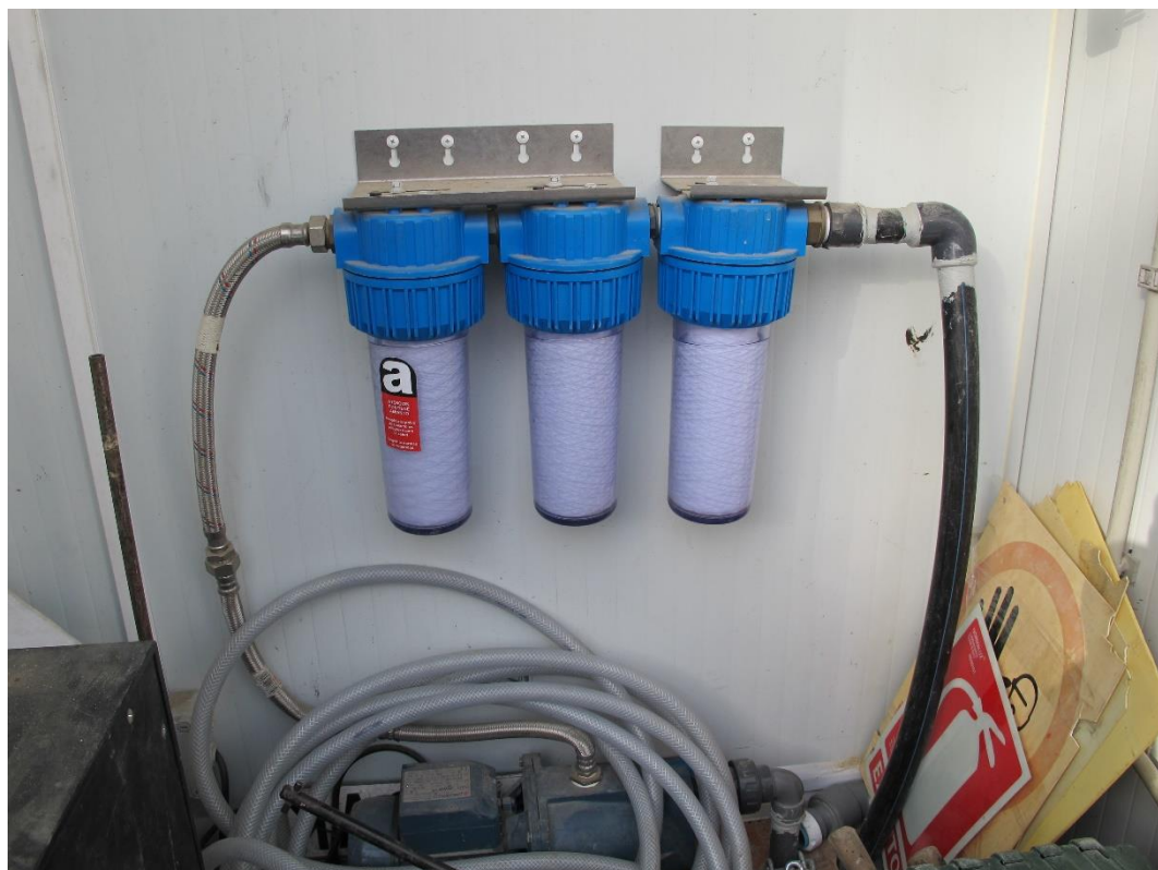
Figura 7. Sistema de tratamiento de agua compuesto por tres filtros para partículas. Fuente: Elaboración propia.
