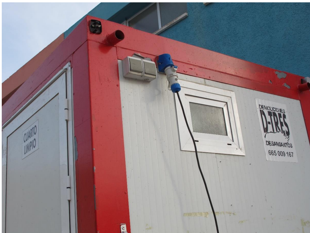
Figura 3. Conexión de la UMD a la red eléctrica. Fuente: Elaboración propia.
