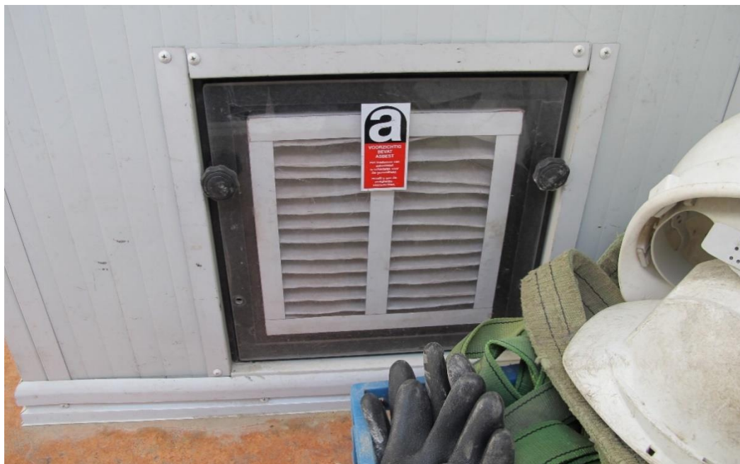
Figura 4. Aspirador con filtro de alta eficacia, interior cuarto sucio. Fuente: Elaboración propia.
