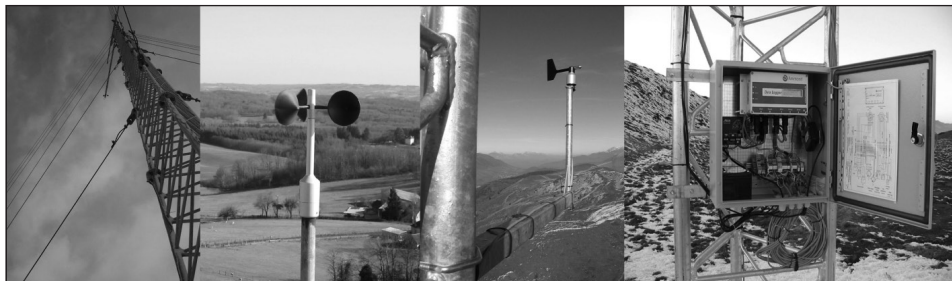
FIGURA 3. Torre de medición de celosía, anemómetro, veleta y data logger
