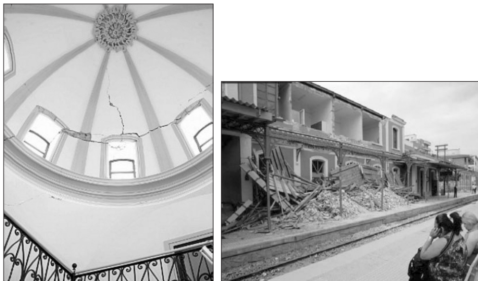
FIGURAS 16 y 17: A la izquierda, cúpula del Conservatorio, fracturada. A la derecha, derrumbe producido en la Estación, en la que el muro de fábrica de ladrillo perdió el equilibrio y cayó sobre la marquesina, rompiendo el entramado de viguetas.
