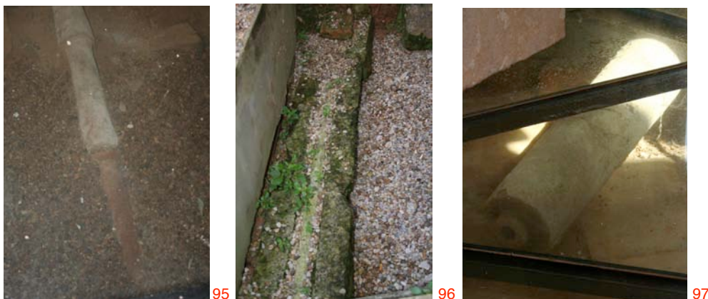
95 tuberías cerámicas próximas al lavatorio. 96 canalización de plomo sobre sillería. 97 canalización mediante piezas pétras perforadas.
