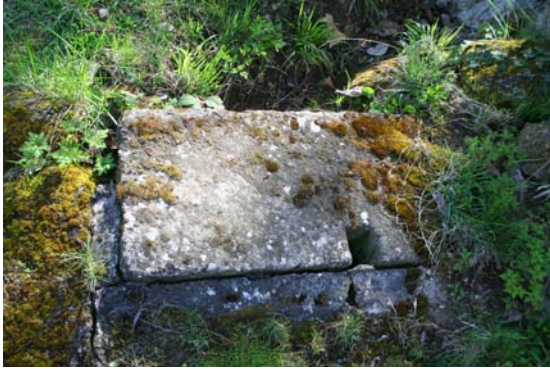
Arqueta de registro en brazal proveniente del río Piedra.
