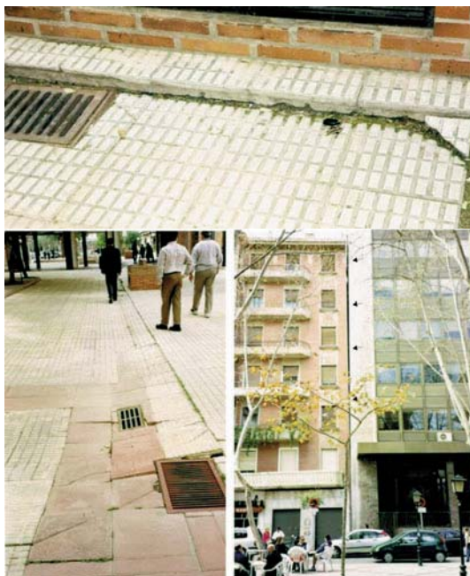
Fig. 16. Ejemplos de patologías en infraestructura urbana y edificación. Obsérvese como incrementa la separación entre los dos edificios con la altura.
