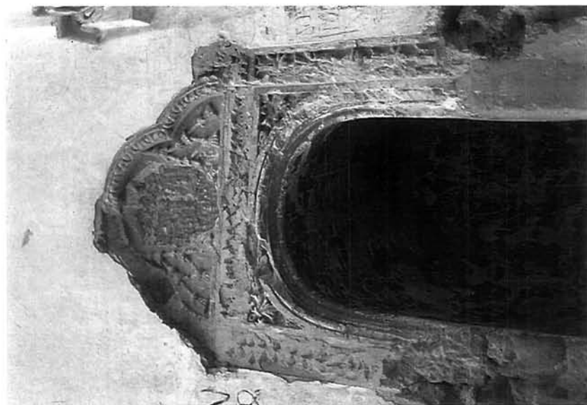
Fig. 1 - Monasterio de Montearagón (Huesca). Restos de yeserías en la iglesia.
