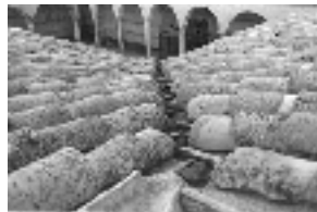
Testour. Sistema de evacuación de aguas pluviales sobre la terraza de la Grande Mosquée en 1984
