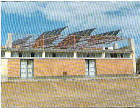
Utilización de paneles solares para calentar agua en viviendas.
