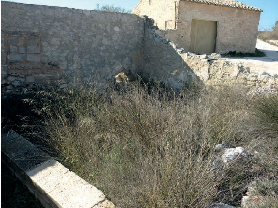
Figura 2. Estado original de la estructura del lavadero previa a la actuación (2014). Fondo de Asoc. Xinoso.
