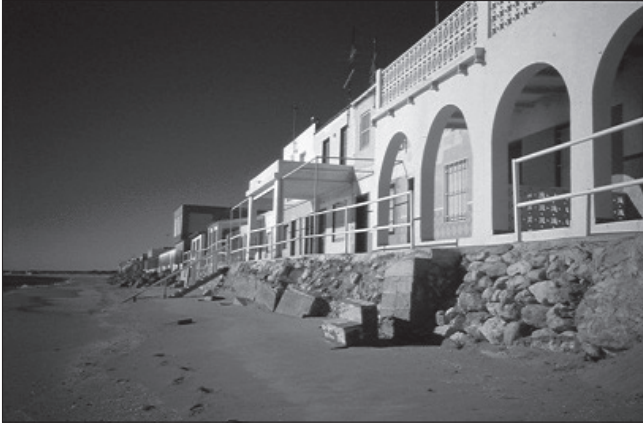
Photo 1 - Occupations en régime de concession administrative sur la plage de El Pinet et problèmes de sécurité face à l'érosion du trait de côte, commune d'Elche, province d'Alicante – Photographie: F. Torres
