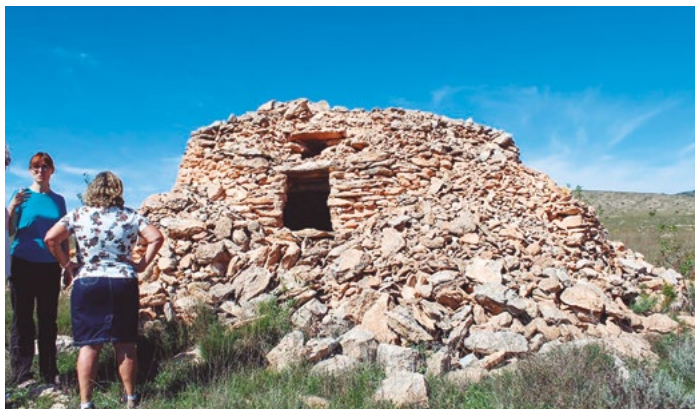
Figura 7. Cuco colapsado en Pinoso (Alicante), (foto: Yolanda Spairani)
