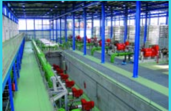
Fig. 11. Bombeo de Agua Filtrada.
