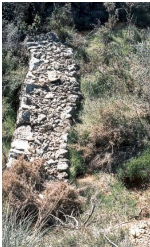
Foto 3. Muros de piedra seca en Alicante impiden la aceleración de los procesos de erosión. La acción del hombre puede favorecer la reducción de las tasas de erosión.
