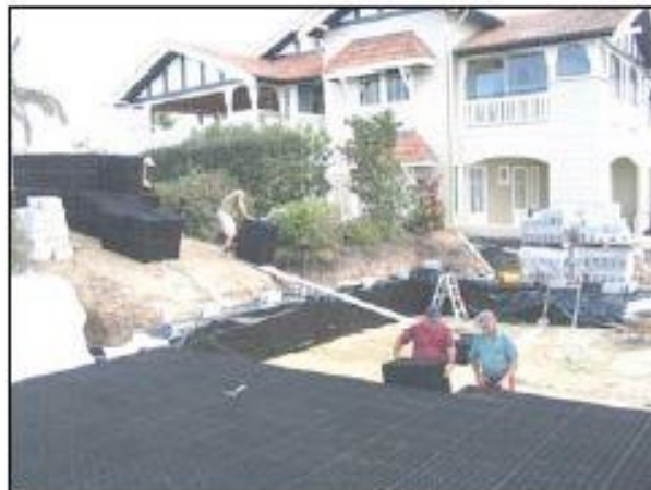
Figura 14. Depósito de detención enterrado. Fuente: ovacen.com
